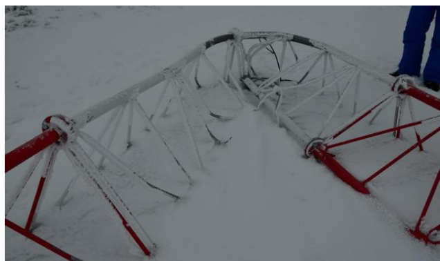
Рис. 8. Згин щогли в місці з'єднання секції 10-ї та 11-ї
