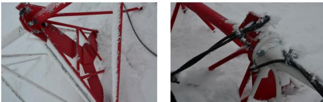
Рис. 6. Діафрагма жорсткості в місцях кріплень відтяжок
