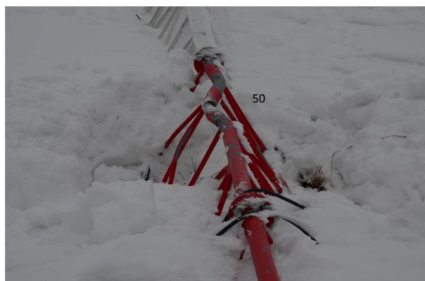
Рис. 13. Деформації і розрив труби в секції 50
