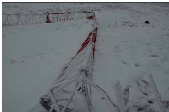
Рис. 9. Секції 11–19 (на передньому плані секція 19 – зруйнована)
