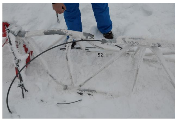
Рис. 14. Деформації і розрив труби в секції 52
