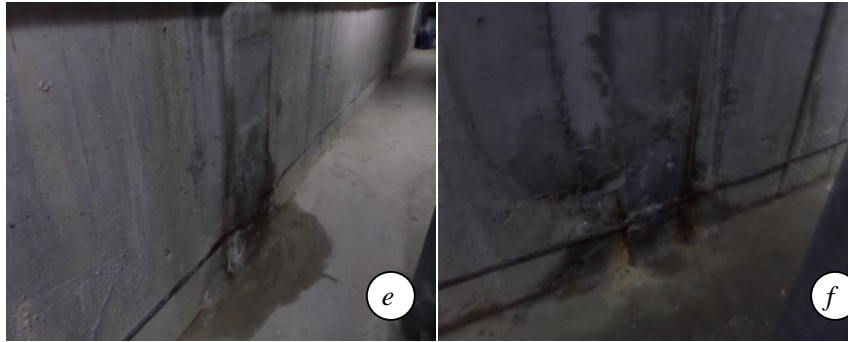
Рис. 6. Характерні дефекти і пошкодження басейну Сихів: а – початкове руйнування бетонної стінки назовні, початок карбонізації бетону (причина активного конденсації); б; с; f – точкове замокання вертикальних швів у нижній частині; e; d – вигляд незначного замокання монтажних швів (вигляд знизу) з технічного поверху
