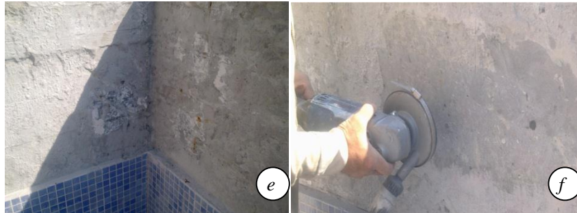
Рис. 5. Характерні пошкодження конструкції басейну Сокільники:
