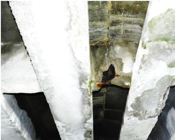
Рис. 5. Пошкодження з'єднання діафрагми та нижньої полицки балки у прогоні 2-3
