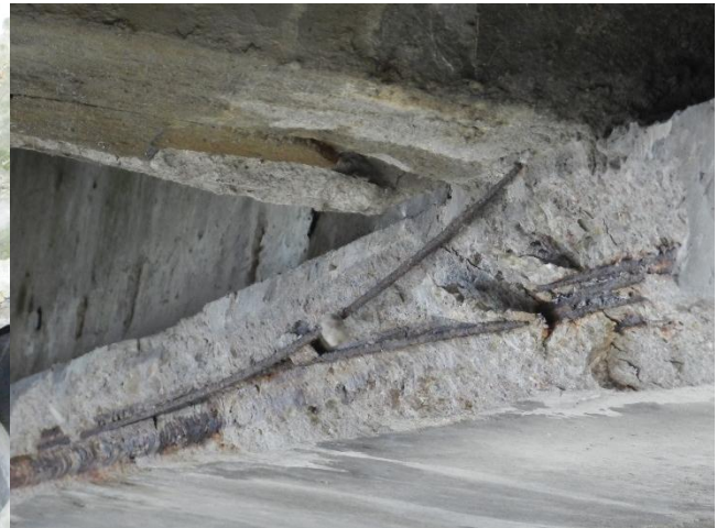
Рис. 6. Розрив арматури балки № 9 прогону 2-3
