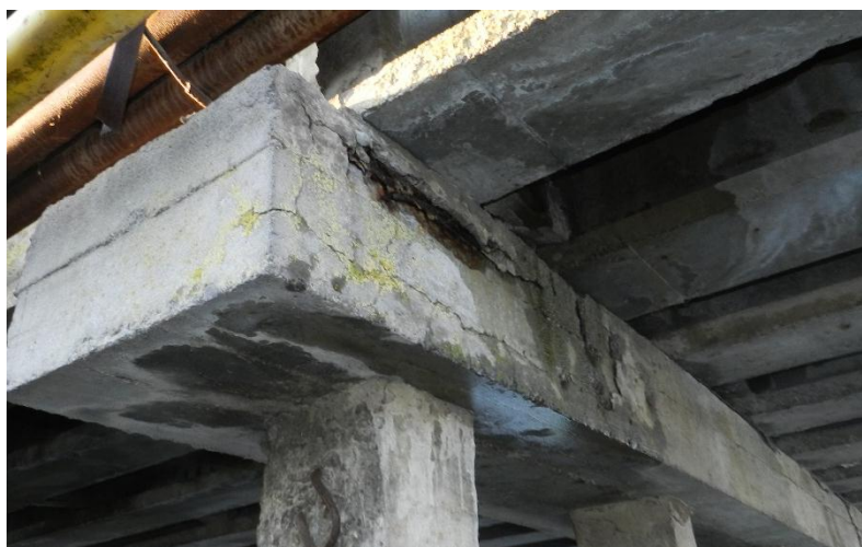
Рис. 4. Загальний вигляд опори №3 та пошкодження бетону насадки опори
