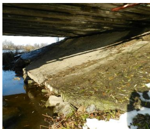
Рис. 3. Руйнування укріплення конусів берегової опори №4
