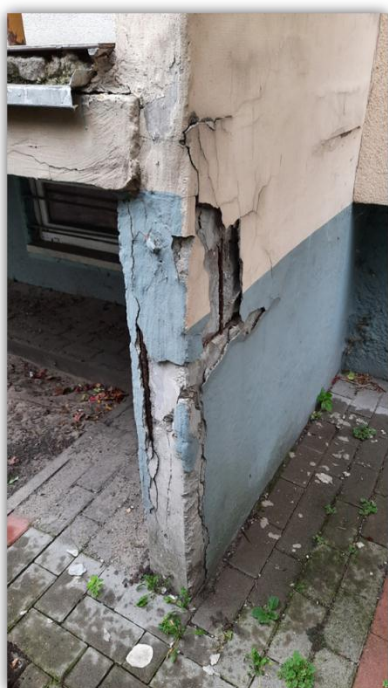
Rys. 7. Korodowanie siatki zbrojeniowej na ścianach loggii
