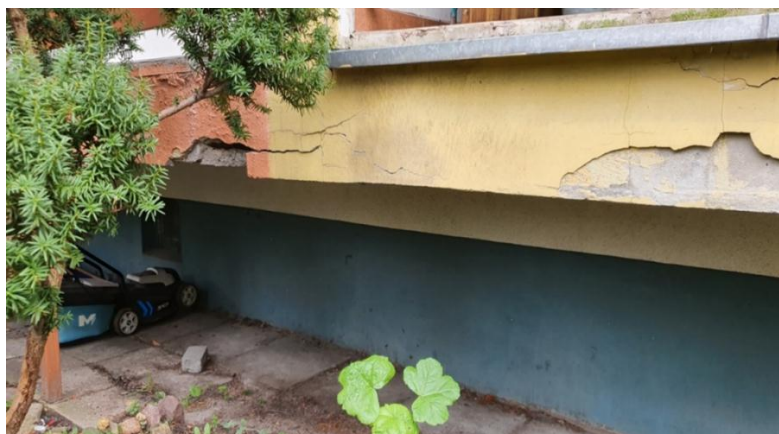
Rys. 6. Uszkodzenia płyty balkonowej w budynku wielkopłytkowym
