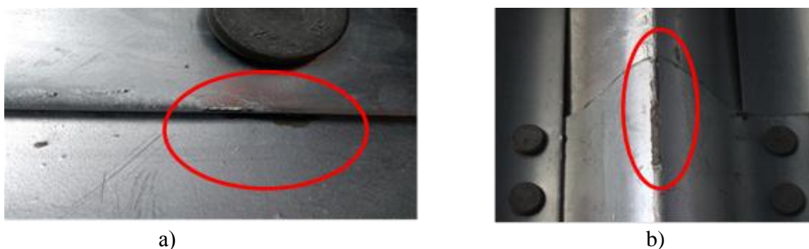
Рис. 1. Розтріскування цинкового покриття металевої гофрованої конструкції
