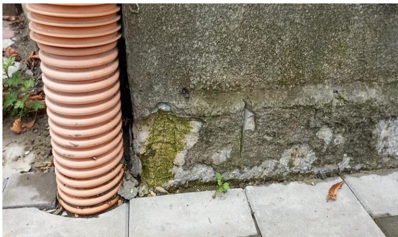
Рис. 3. Тріщини та відпадання оздоблювального шару в цоколі будівлі
