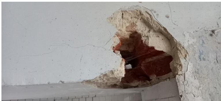
Рис. 5. Механічні пошкодження цоколю будівлі
