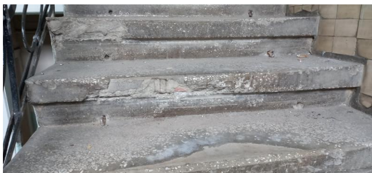
Рис. 9. Вибoїни на бетонних сходах центральної сходової клітки, що сполучає центральний вхід із першим поверхом
