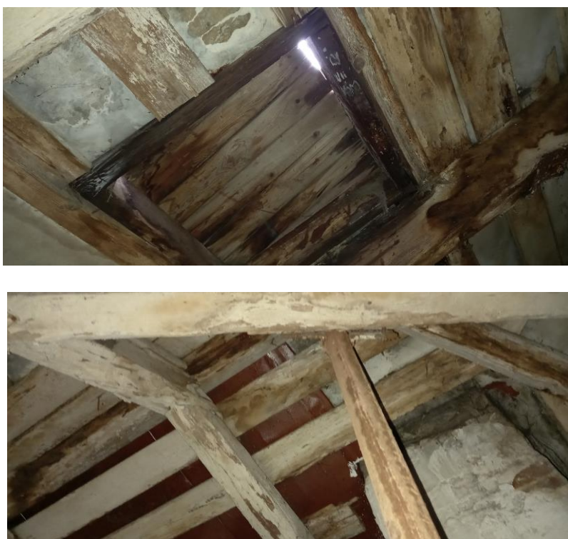
Рис. 11. Загальний вигляд конструктивних елементів даху (сліди трухлявості, розтріскування, затікання)
