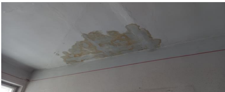
Рис. 8. Сліди замokання перекриття над другим поверхом (протікає дах)
