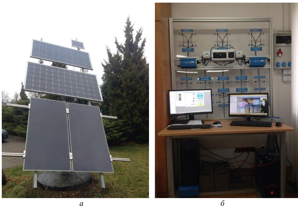
Рис. 1. Експериментальний стенд: а) фотоелектричні панелі; б) моніторингова система Fig. 1. Test stand: а) photovoltaic panels; б) system monitoring
